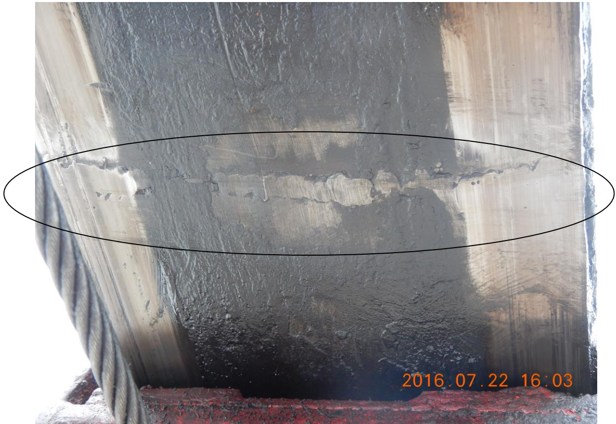
第二節伸臂下翼板原修補鋸道有顯著裂紋
