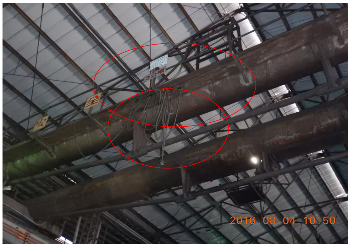
電源供電線(北側)部分線材固定架鬆脫
