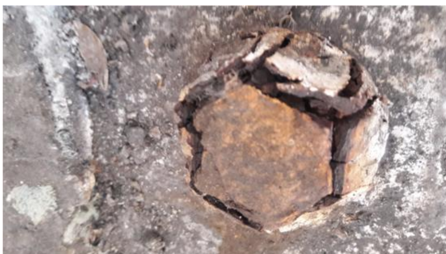
儲槽腳座基礎螺栓銹蝕
