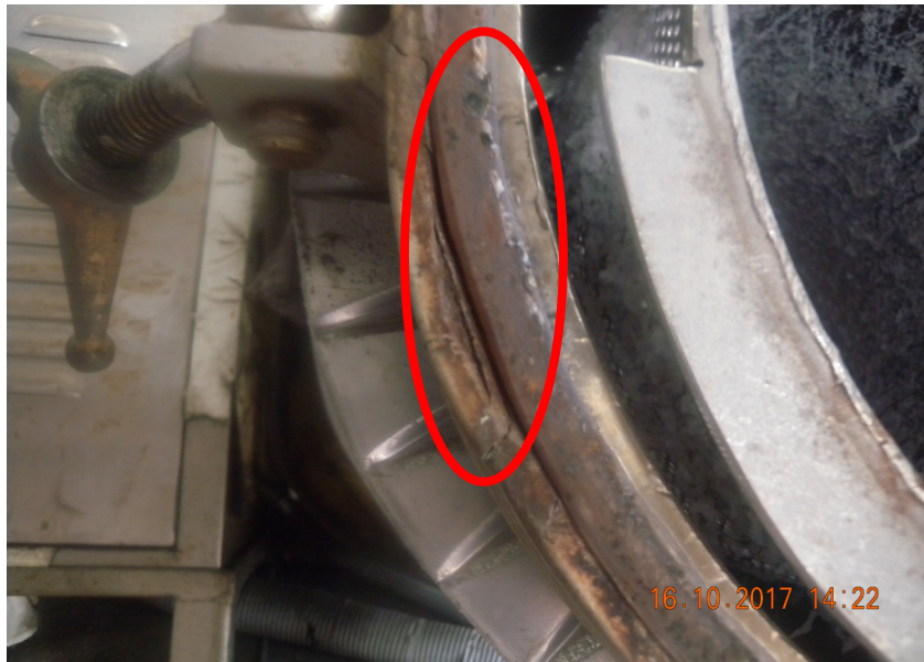
熱交換器胴體凸緣線形龜裂
